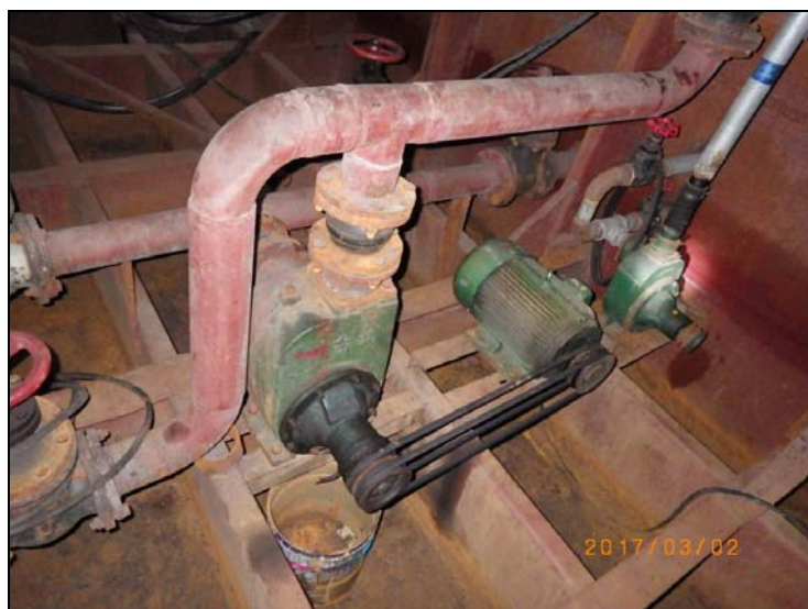
27. 船首后隔舱内电机及水泵。
